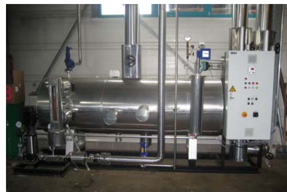
Dampferzeuger der Fa. AKB GmbH mit Wärmeträgerölbeheizung
